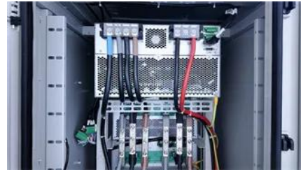
Sol-Up Solar , Premier Las Vegas Solar Provider
